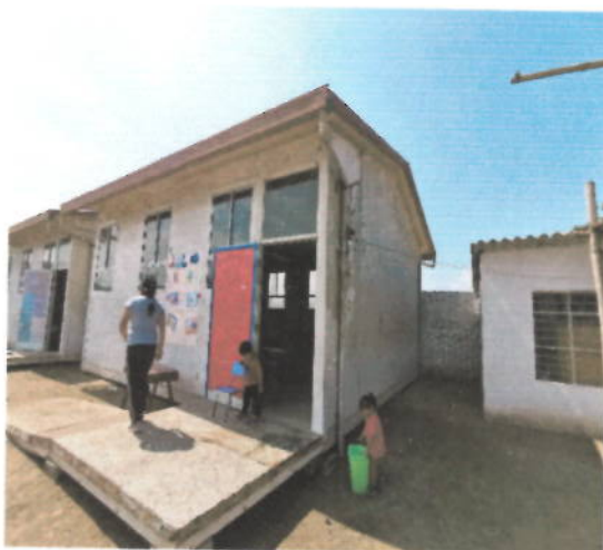
Foto N° 05: Vista de MPF sin barandas y oxidadas
