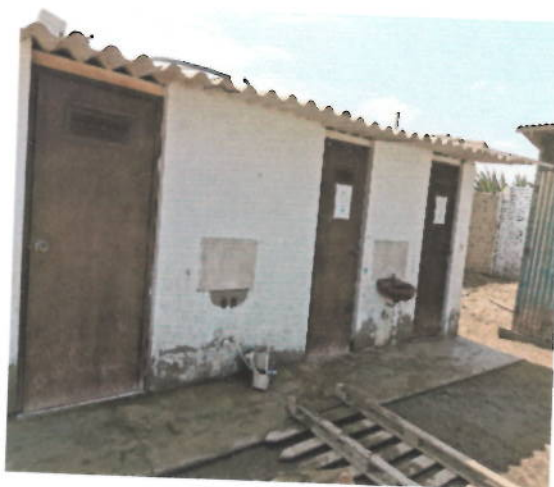
Foto N° 05: Se observa lavatorio quebrado se debe sustituir
