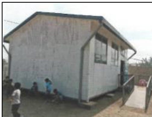
Vista fotográfica N° 01.- Módulo de MPF existente en la zona, se observa Módulos sin barandas
