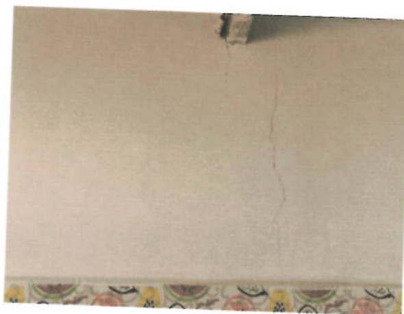
Foto N° 03: Vista de fisuras en muro de cocina
