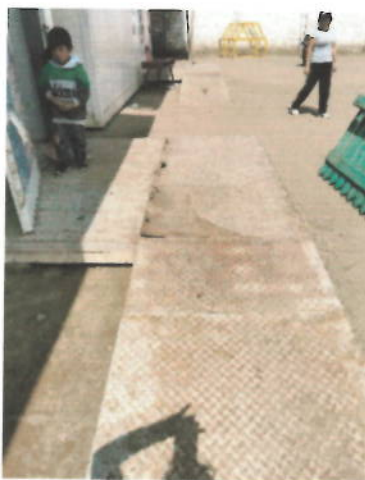
Foto N° 03: Rampa de ingreso en mal estado de conservación
