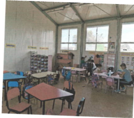
Foto N° 02: Interior de Aula prefabricada en regular estado
